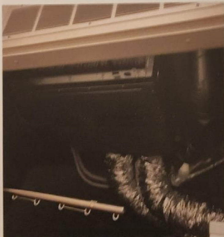
De kanalunit, bevestigd aan het plafond in de technische ruimte.
