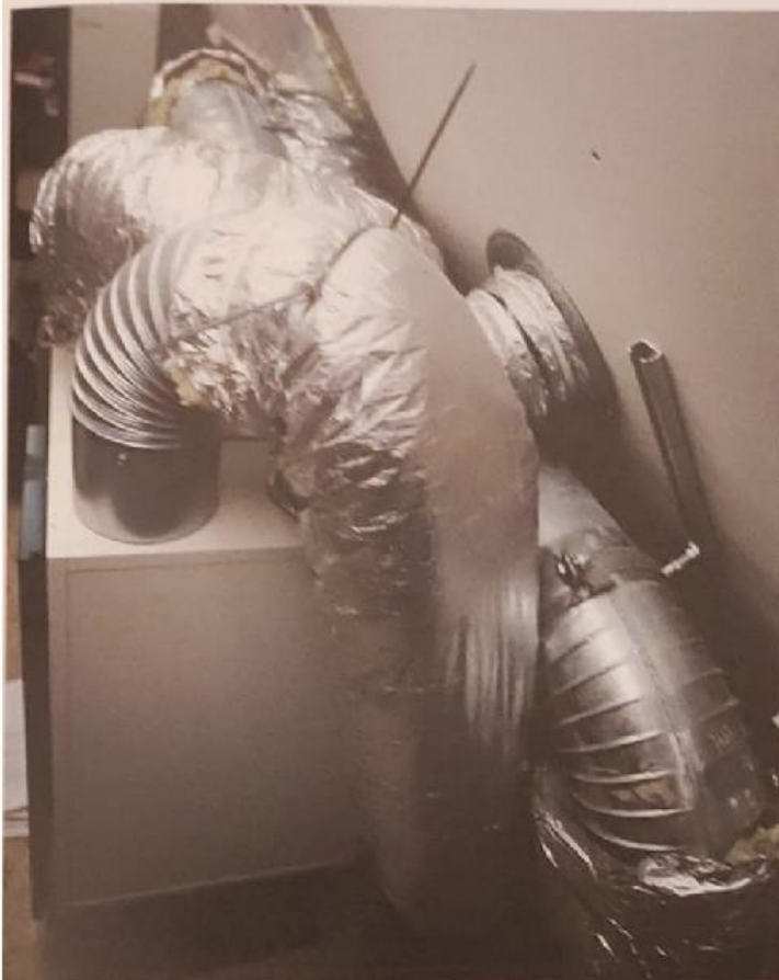
De WTW-unit, met een lucht slang naar de kanaalunit.
