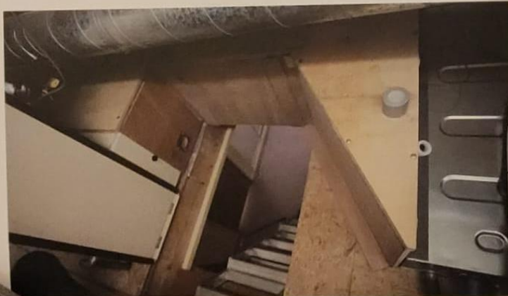
Het kanaal tussen de warmtepomp (rechts) en de Brink-ketel (links) is om het trapgat heen geconstrueerd.
