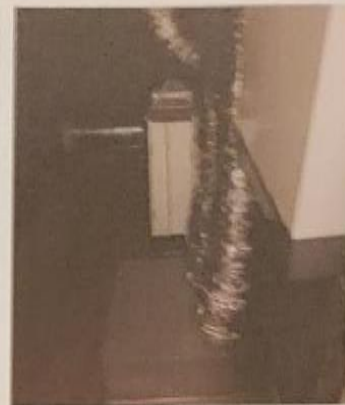
De aansluiting van de luchtslangen van de warmtepomp op het luchtkanalenstelsel van de woning, op de plek waar voorheen de Thermo Air stond.
